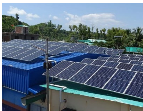
Panneaux solaires derrière le poste de santé de l'OIM dans le camp de réfugiés rohingyas de Balukhali. OIM 2018/Olivia Headon
